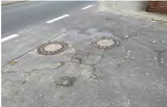
Abb. 74 | Substanzschäden im Bereich der Einmündung Herderstraße in die Hollager Straße
