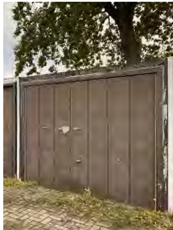
Abb. 73 | Substanzschäden an Garagenkomplexen- hier im Bereich Kurt-Schumacher-Straße
