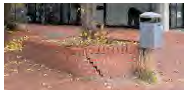
Abb. 67 | Substanzschäden an Baumeinfassung im Bereich Hollager Straße 128
