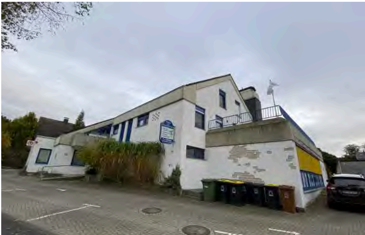
Abb. 78 | Substanzschäden und gestalterische Defizite Hollager Straße 109
