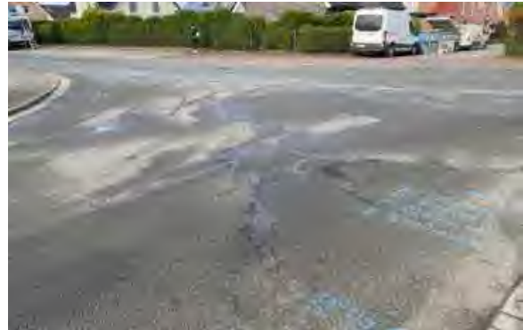
Abb. 55 | Substanzschäden Bismarckstraße Ecke Fiesteler Straße
