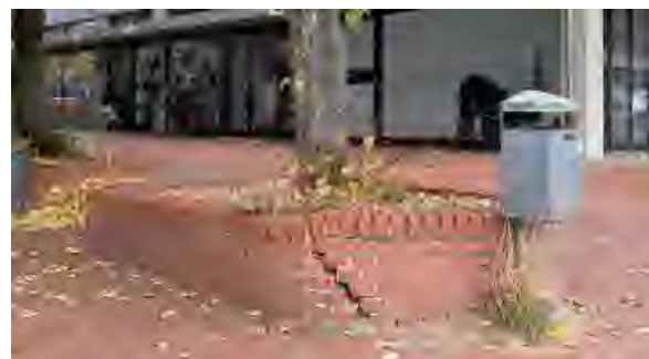
Abb. 46 | Substanzschäden an Baumeinfassung im Bereich Hollager Straße 128
