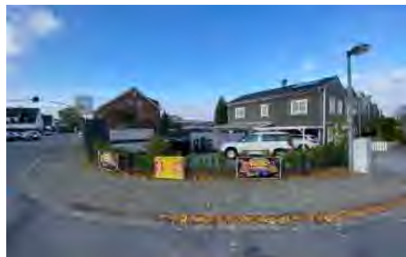
Abb. 70 | Nicht mehr zeitgemäße Bordsteinabsenkung: hier im Bereich Bismarckstraße/ Hollager Straße
