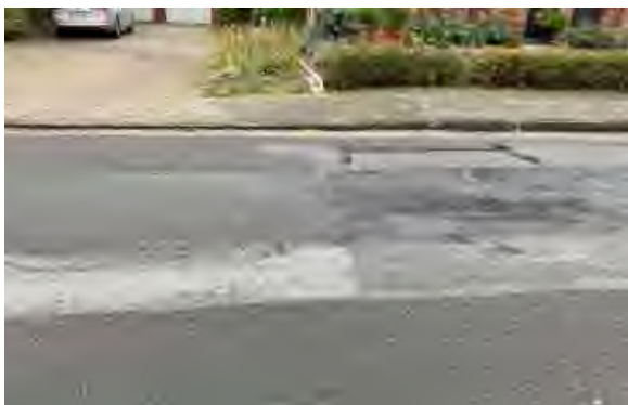
Abb. 48 | Substanzschäden Fiesteler Straße Detail
