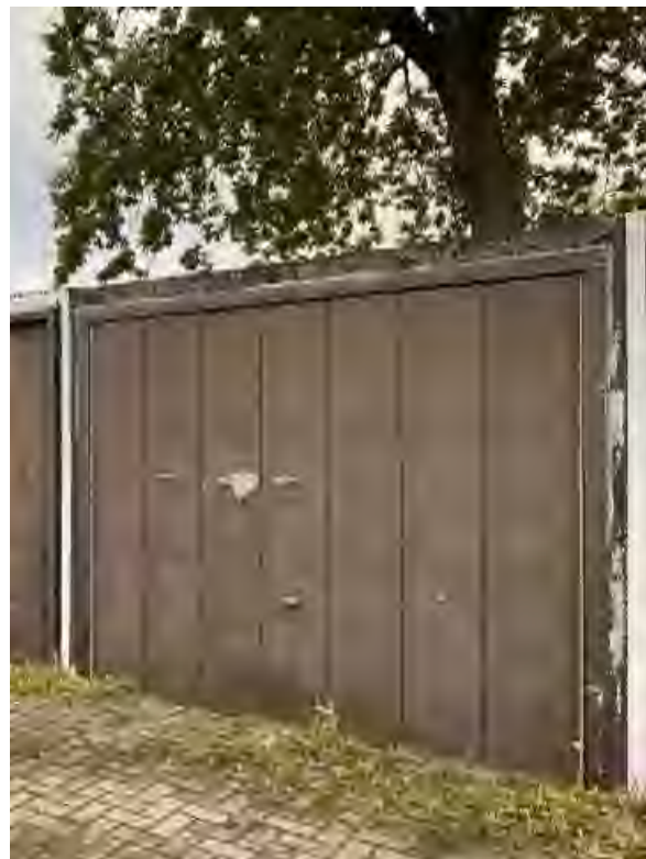
Abb. 52 | Substanzschäden an Garagenkomplexen- hier im Bereich Kurt-Schumacher-Straße
